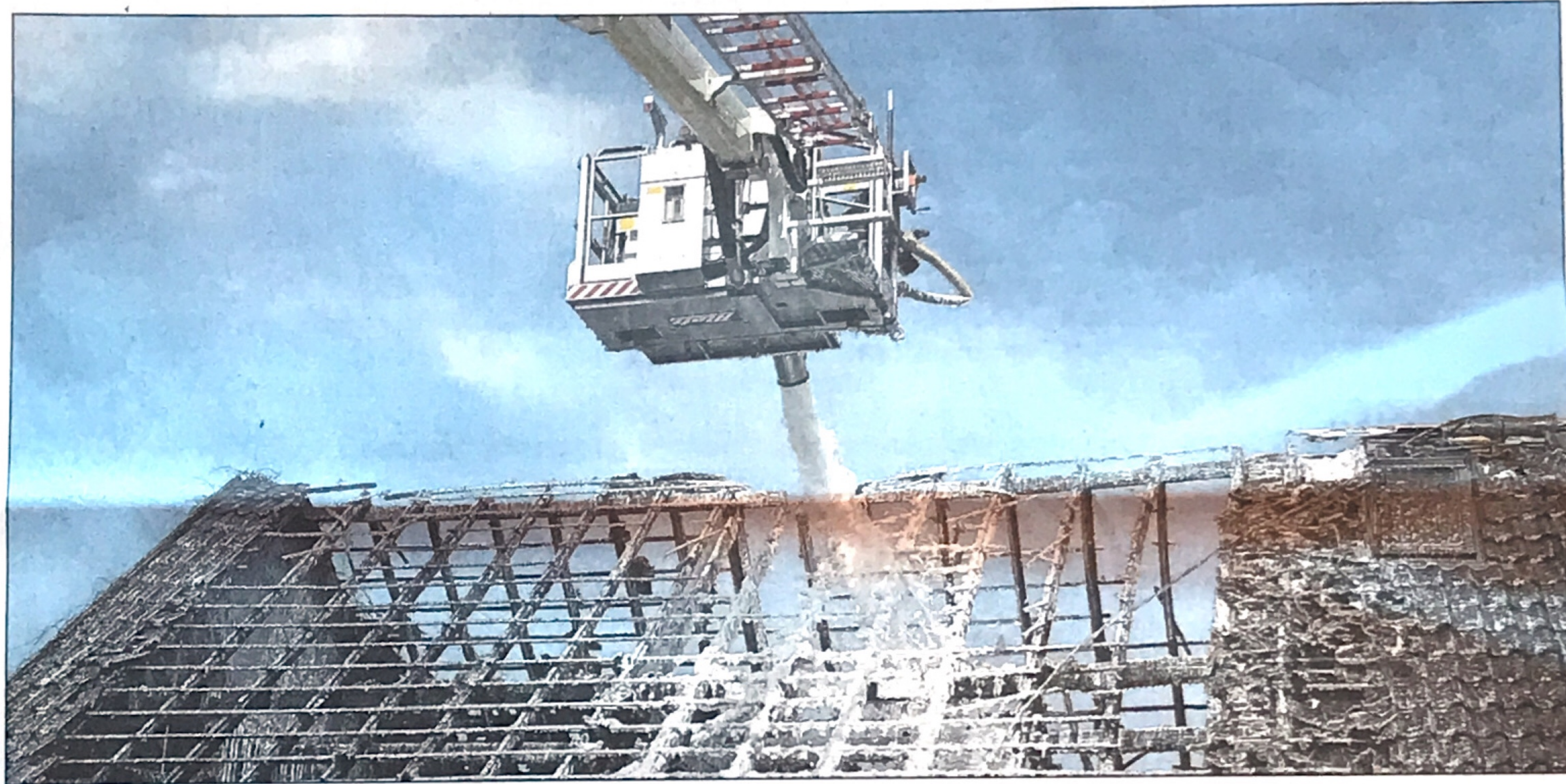
Der Schaden wird auf etwa 250.000 Euro geschätzt.
